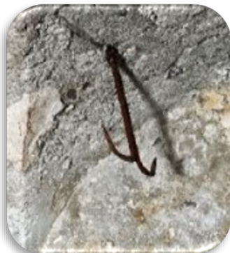
Eisenhaken an der Decke
