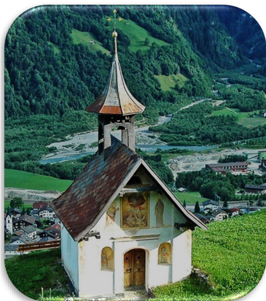
Die Kapelle vor der Sanierung mit Blechdach
